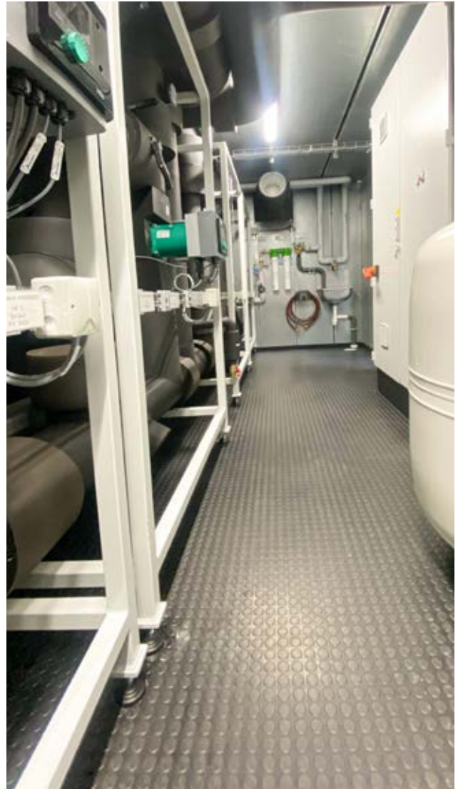
Modulbaugruppen in einer betriebsfertigen Container-Energiezentrale
