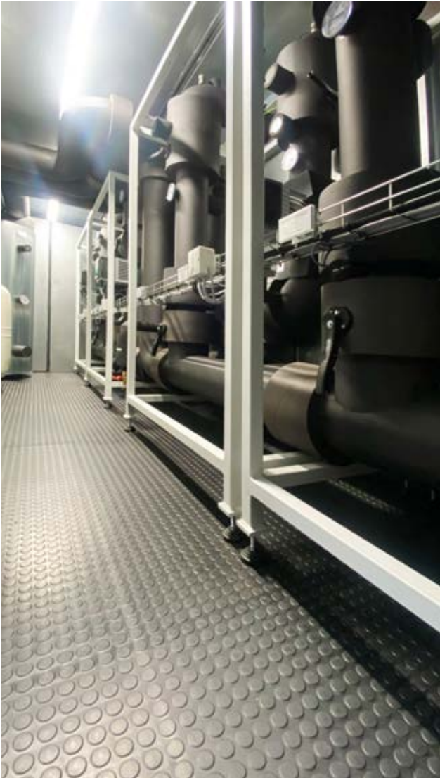
Modulbaugruppen in einer betriebsfertigen Container-Energiezentrale
