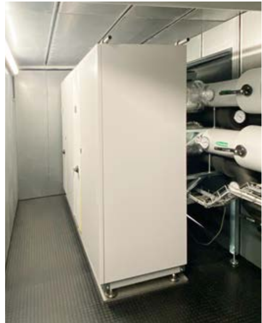
Zwei IDM-Sole-Wärmepumpen Terra SW Max betriebsfertig angeschlossen
