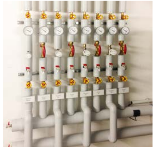
Gebäudehüllentemperierung: Vorgefertigter Temperierverteiler
